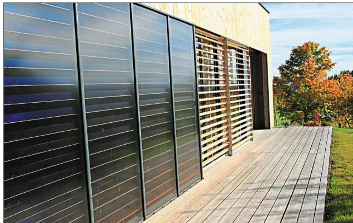
Solarthermie funktioniert auch an der Fassade. – Foto: Energie- & Umweltzentrum Allgäu
